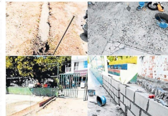
Seis canchas, en cinco barrios de la Localidad 3, tienen fallas estructurales y mala calidad, presuntas irregularidades encontradas poco tiempo después de contratadas las obras, indicó Funcicar.
